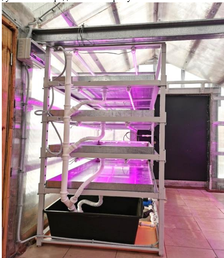
Рисунок 1 - Гидропонная установка как комплекс по исследованию систем выращивания зеленных культур
